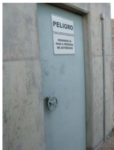
Figura 5. Puerta con blindaje de plomo.
