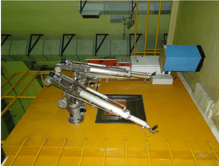
Figura 6.3: Celda de manipulación de sustancias activadas en el reactor RP-10 de Huarangal, Lima, Perú. Foto IPEN.
