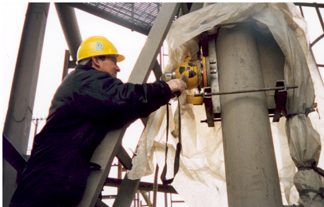
Figura 10.4: Una fuente radiactiva y un detector de radiactividad se instalan adecuadamente para que el paso de material por un tubo interrumpa la llegada del detector y alertar en caso de atoro. Foto IPEN.
